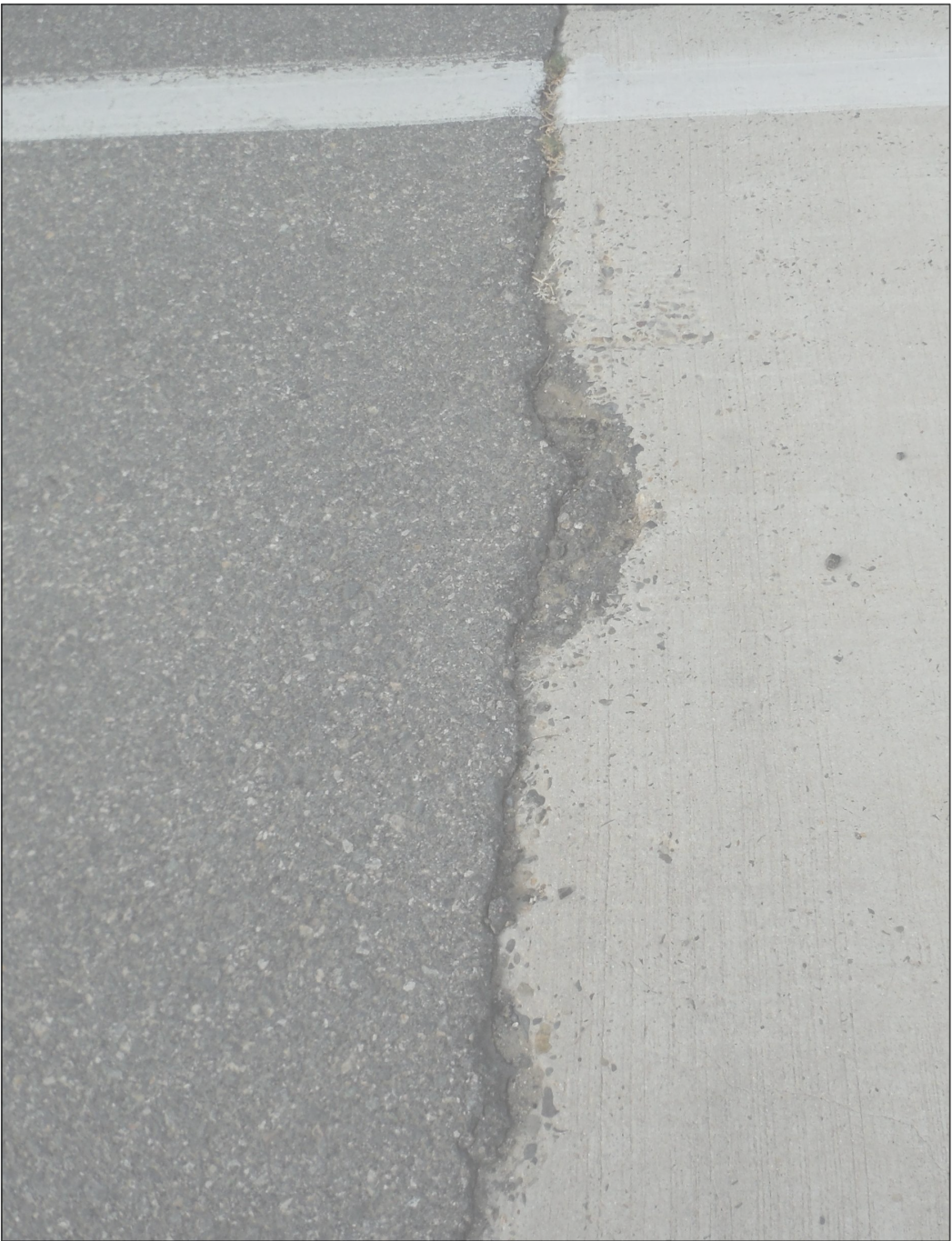
B C-001 TYPICAL EDGE SPALL DAMAGE SCALE: NONE
