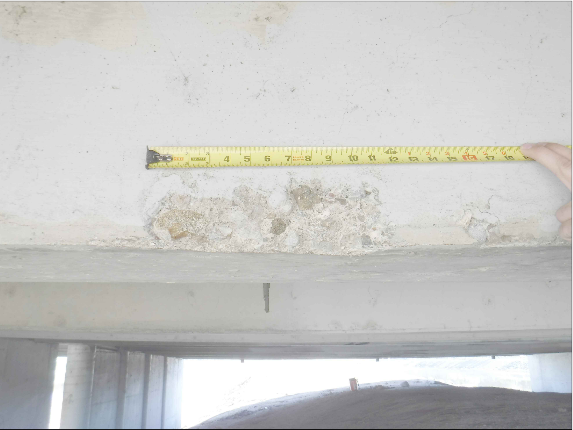
B VIEW OF SPALL C-001 SCALE: NONE
